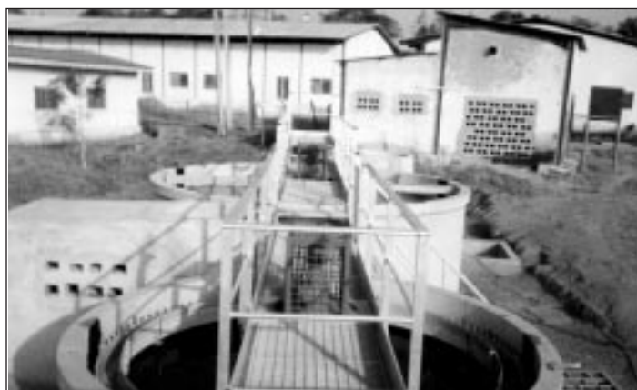
Pilote de traitement d'eaux résiduaires SOAF
