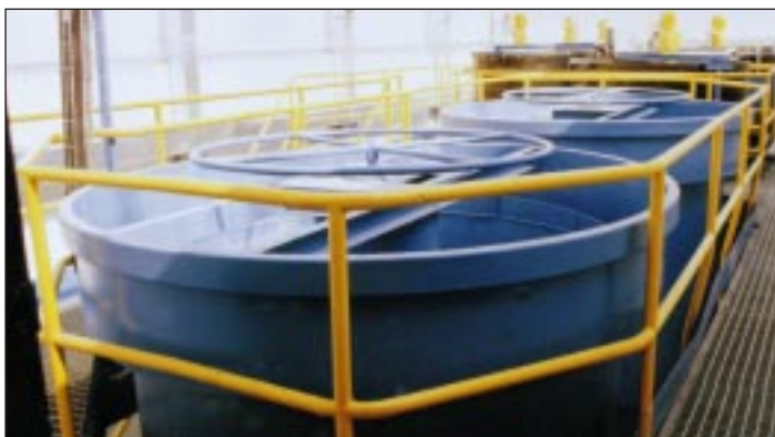
Le pilote d'épuration STEREAU
