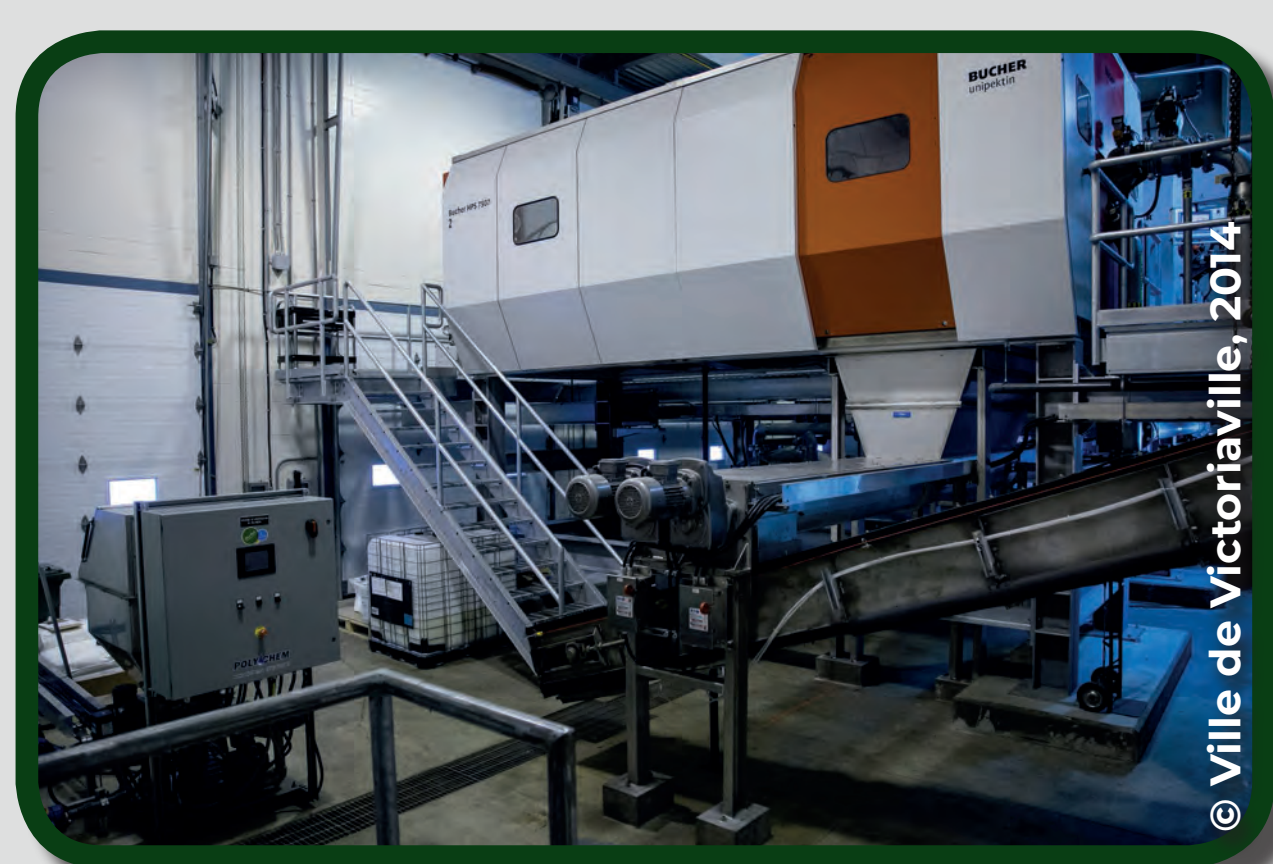
Dispositif de traitement des eaux usées industrielles
